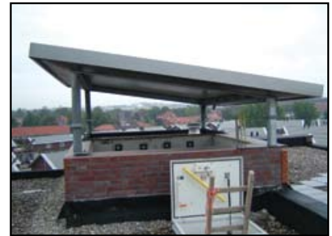
In parkeergarage Bergoss is sprake is van beperkte ruimtes met kleinere afzuigschachten en een grotere afzuigcapaciteit.
